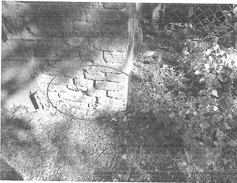
Fot. 6. Ubytki w fugach w strefie cokołowej.
