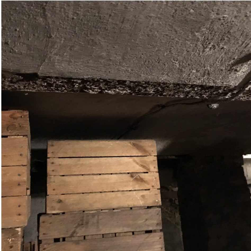
Fot. 13 - Korozja belek od spodu
