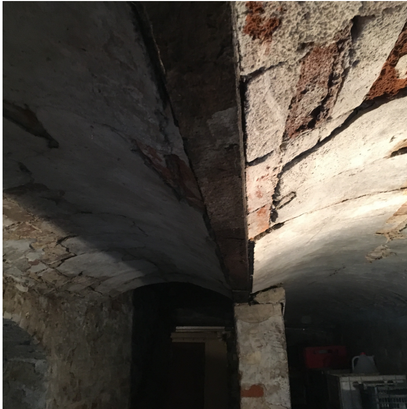
Fot. 5 - Skorodowana belka
