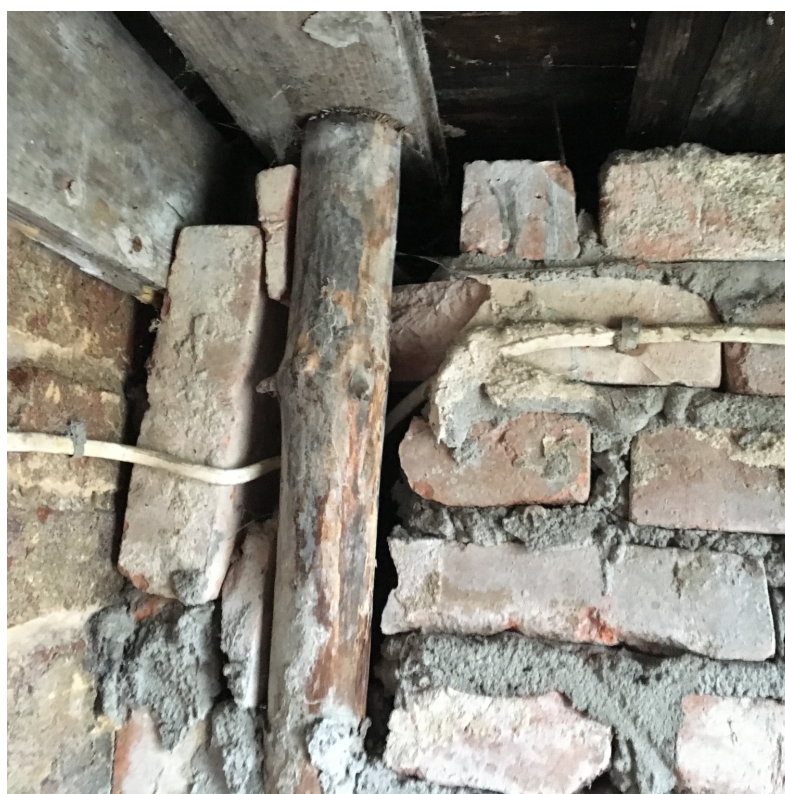
Fot. 2 - Ubytki w murze przy sklepieniu łukowym (strefa wejściowa)
