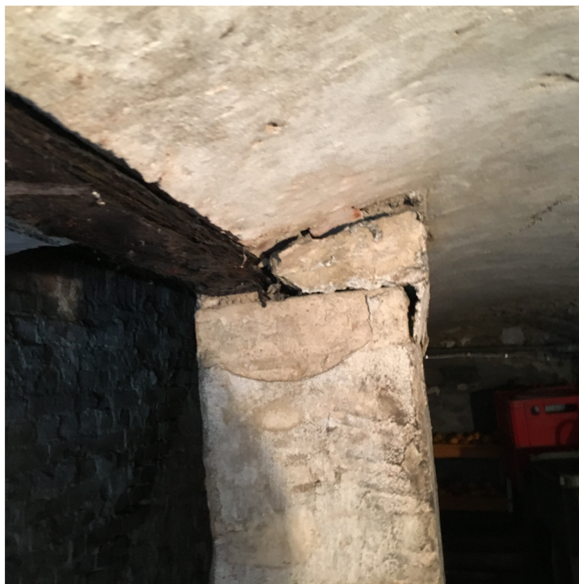
Fot. 1 - Filar - odspojenie przy sklepieniu, odchylenie od pionu
