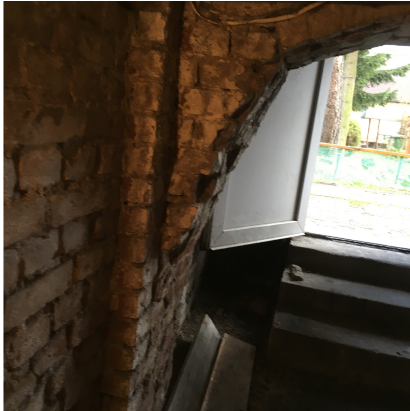
Fot 3. - Ubytki w sklepieniu łukowym (strefa wejściowa)
