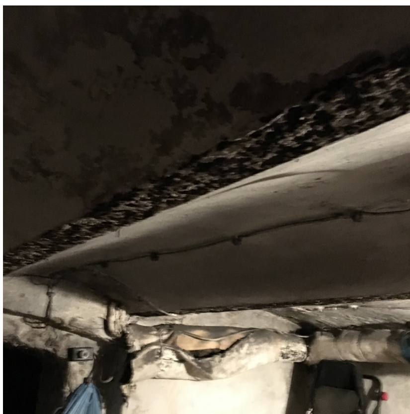
Fot. 12 - Korozja belek od spodu
