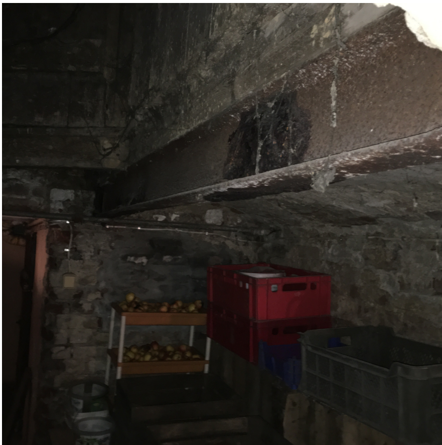
Fot. 6. - Skorodowana stopka belki
