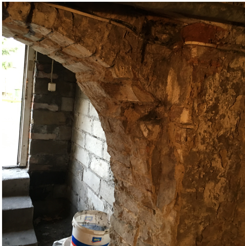
Fot 4. - Ubytki w sklepieniu łukowym (strefa wejściowa)
