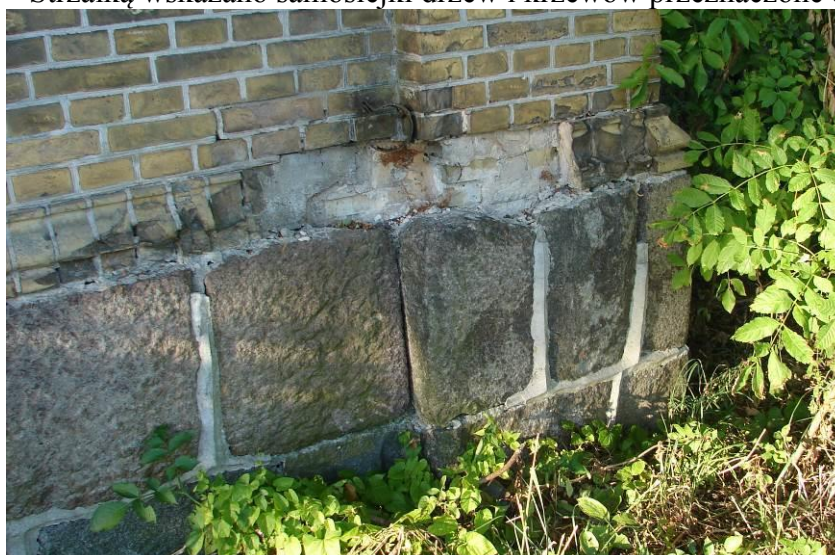
6. Uszkodzenia w obrębie cokołu na skutek nieszczelności orynnowania - elewacja południowa
