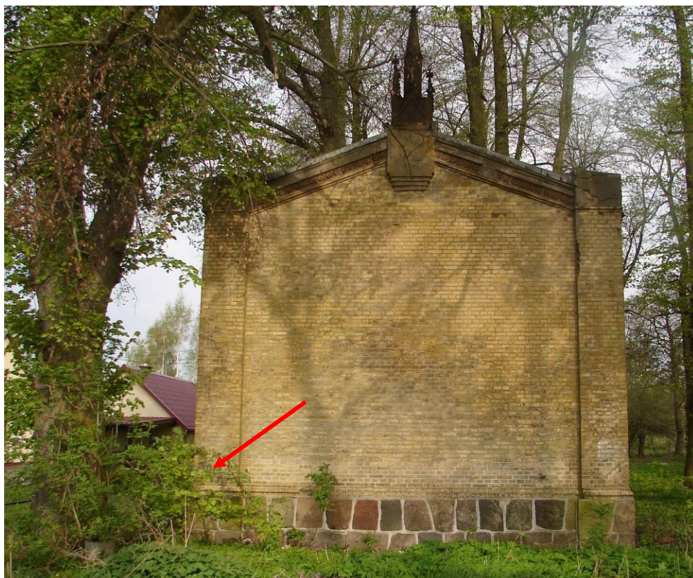
3. Elewacja wschodnia - tylna drzewo rosnące bezpośrednio przy elewacji Strzałką wskazano samosiejki drzew i krzewów przeznaczone do wycinki.
