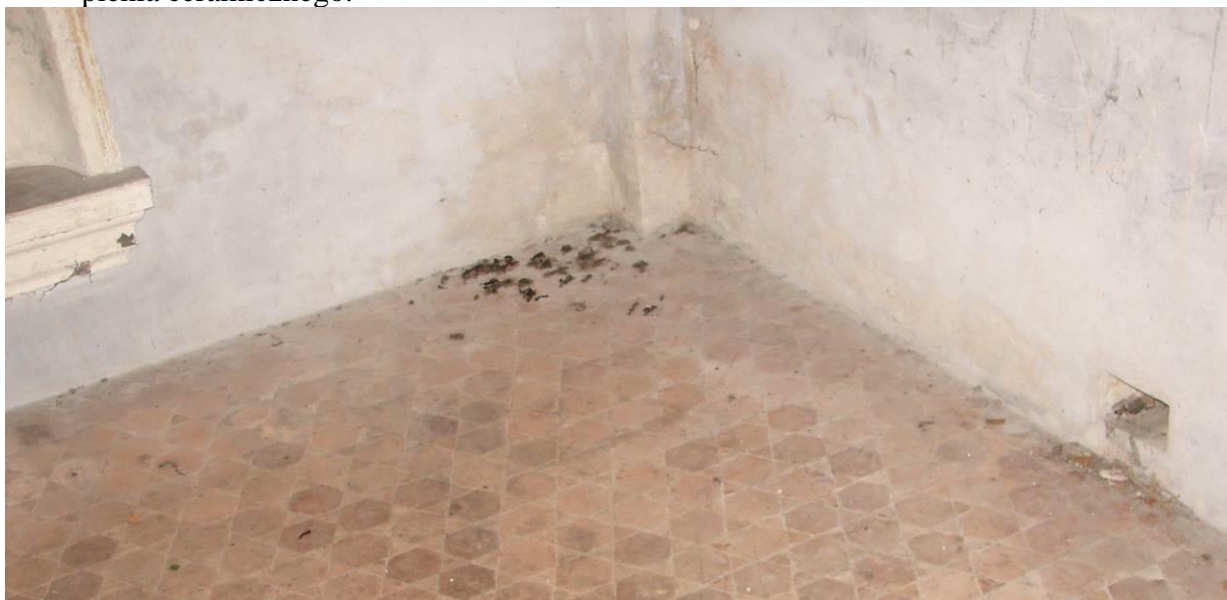
22. Posadzka ceramiczna kaplicy, w narożniku widoczne zawilgocenia i korozja tynków
