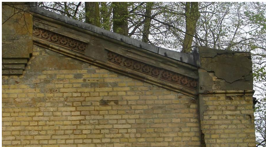
11. Wtórne zaprawy cementowe na elewacji wschodniej
