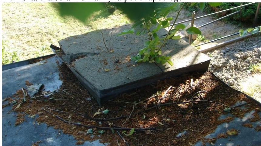
13. Spękania korony pilastra, rośliny nasienne rosnące w spękaniach
