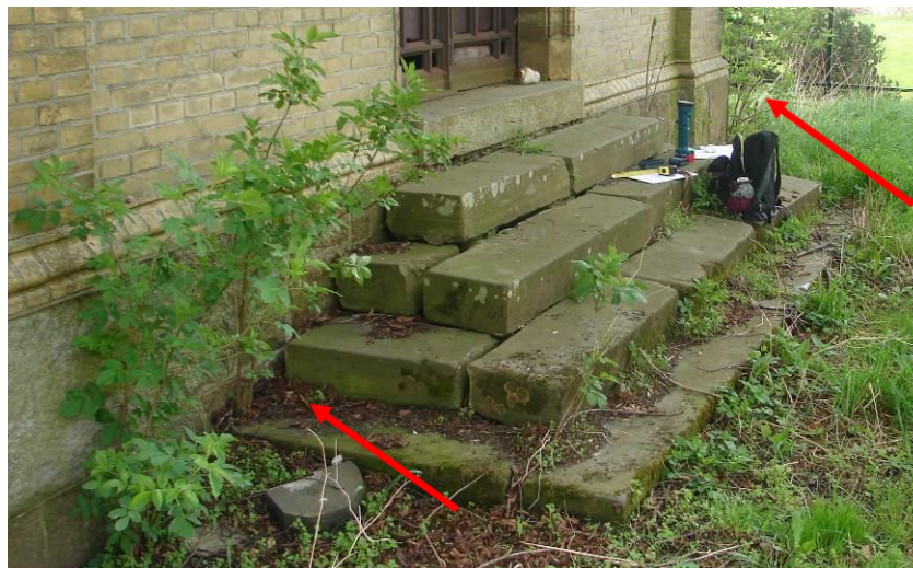
5. Zdestabilizowane schody z bloków piaskowca. Strzałką wskazano samosiejki drzew i krzewów przeznaczone do wycinki.
