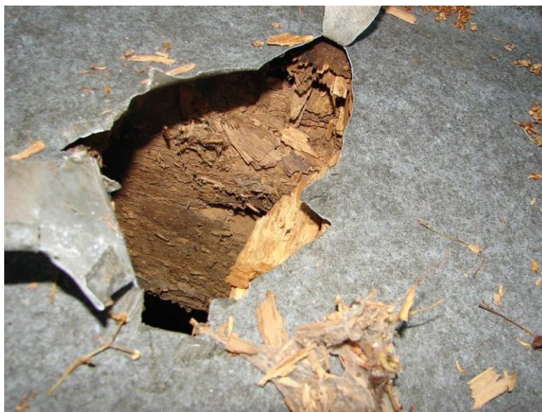
14. Porażenie elementów drewnianych przez grzyby domowe
