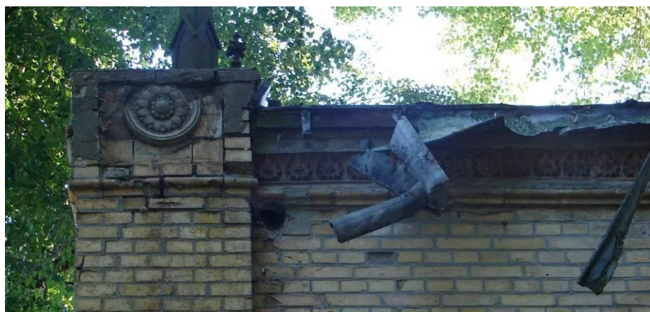
8. Zły stan techniczny orynnowania
